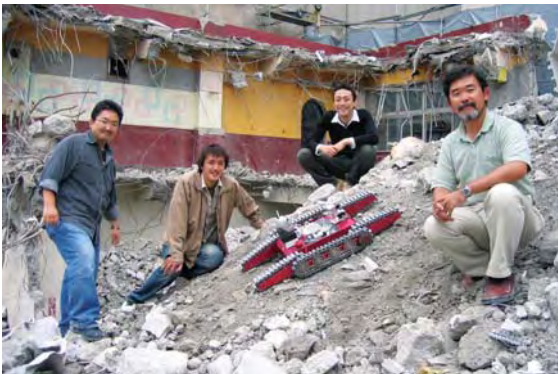
解体工事現場を借りてのレスキュー・ロボットの実験
